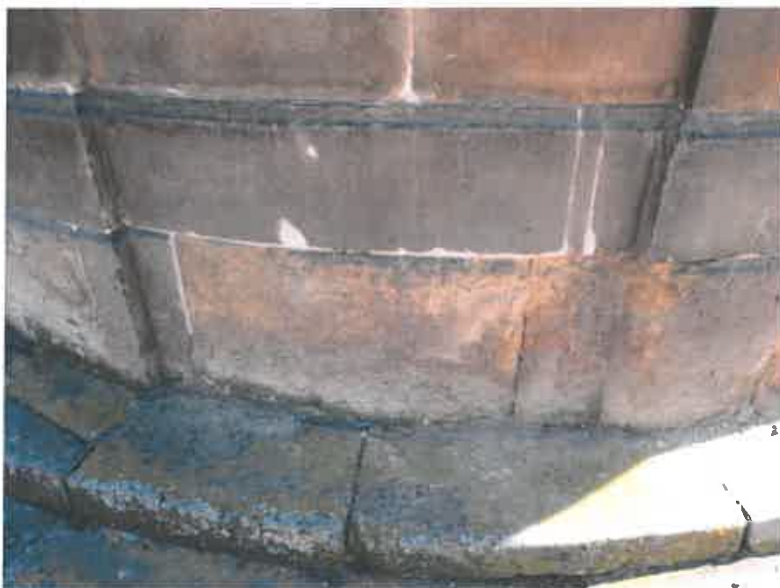
5. Schody s kamenickou skobou, porušený kámen podstavce
